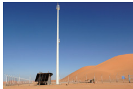
Antenne de transmission d'information
