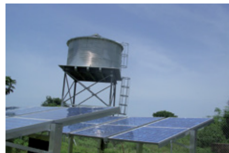
Alimentation d'une pompe pour puiser l'eau
