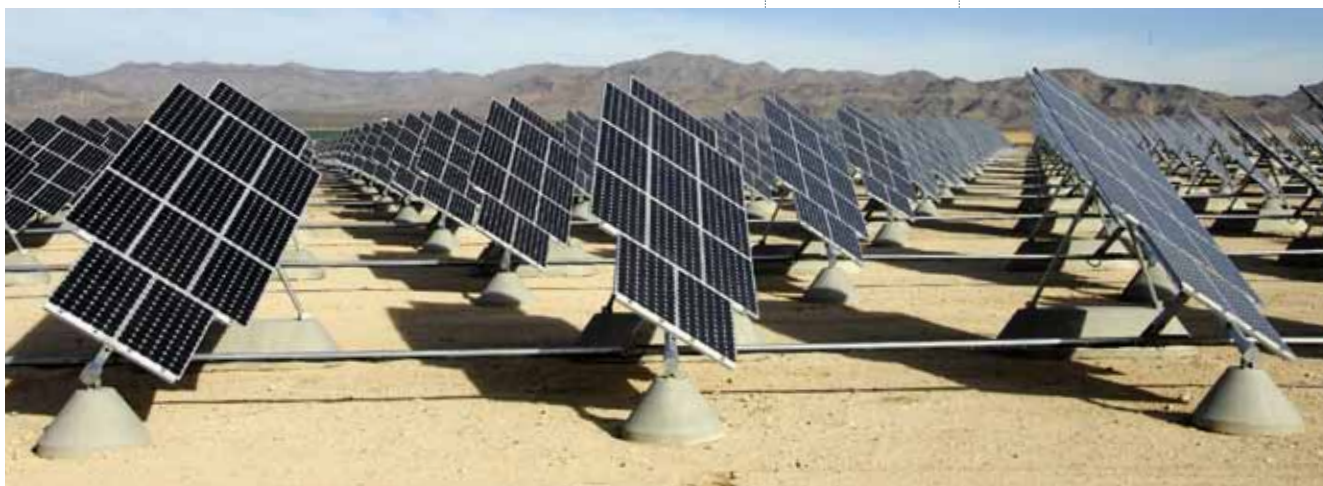
Installation photovoltaïque sur la Nellis Air Force base dans le Nevada, États-Unis.
